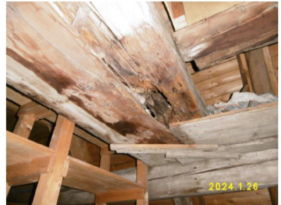
Tragbalken unter Dachreiter in Achse 3 massiv geschädigt
