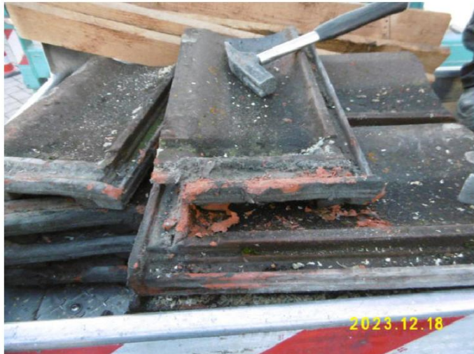
Frostschäden in Form von abmehlenden Kanten an den Ziegeln
