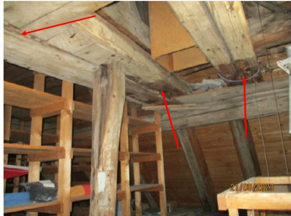
Schadhafter Tragbalken unter Dachreiter notdürftig abgestützt
